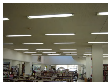
高効率照明（省エネ型安定器）
