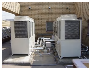
空調の高効率化（冷暖兼用 EHP）
