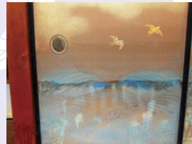
カスリーン台風による浸水の跡
