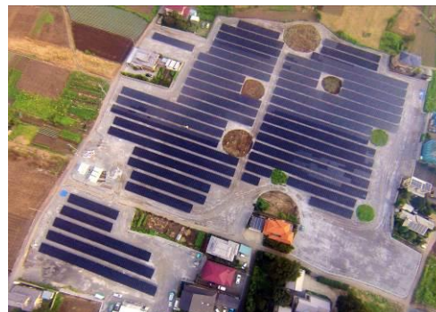
おおた鶴生田町太陽光発電所
