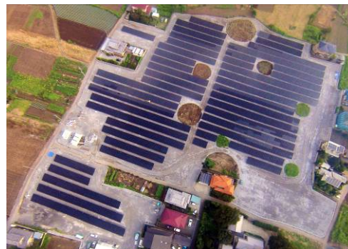
おおた鶴生田町太陽光発電所
