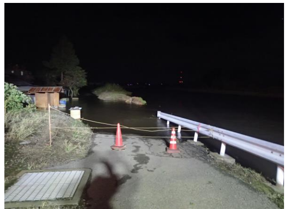
下田島町 石田川橋 越水状況
