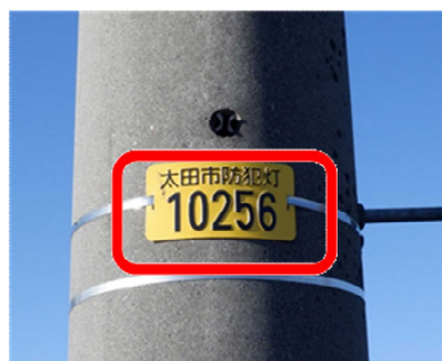
防犯灯管理プレート
