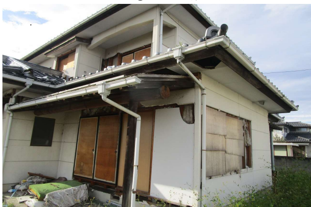
④建物破損状況(東側)
