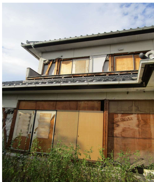
③建物破損状況(西側)
