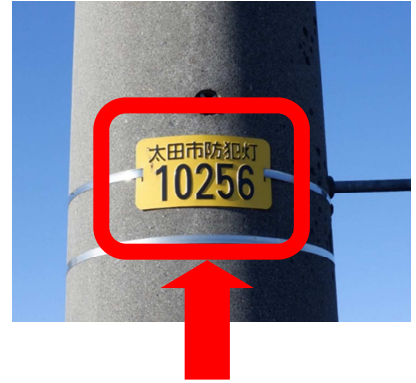
防犯灯管理プレート
