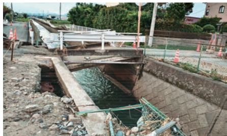
八瀬川橋梁崩落
