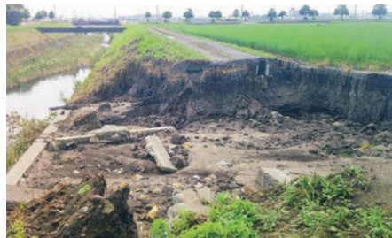
蛇川管理道崩落
