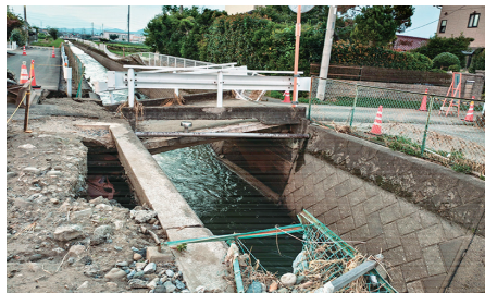
八瀬川橋梁崩落
