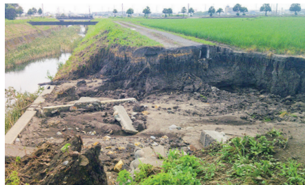
蛇川管理道崩落
