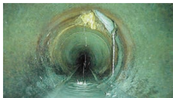
▲古くなって腐食した下水道管
