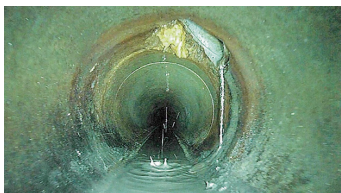
▲古くなって腐食した下水道管
