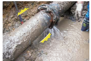
老朽化した水道管
