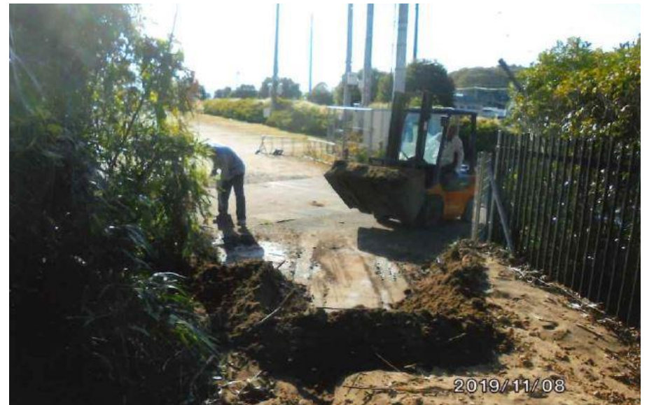
土砂崩れ現場
